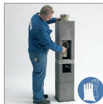
1.8 A vizsgáló nyílással ellátott bordázott samottcsövet központosan a beton lábazati lapra, habarcsba elhelyezzük. A szifont a helyére illesztjük és a bordázott samottcső felső peremére ROTEMPO-t nyomunk.
