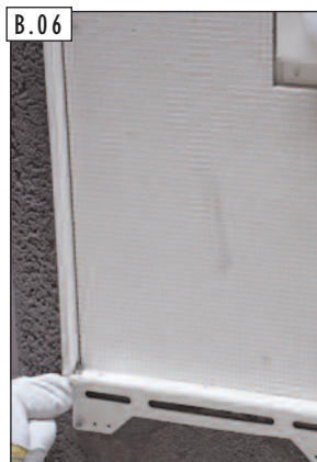
B.06 Pohľad na spodnú oblasť závesu dverí s ochranným tesnením odrezaným na mieste v oblasti závesu dverí.
