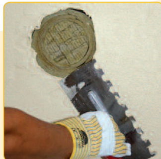
C.2 Na kształtkę IGNIS PROTECT nanieść warstwę STO-Levell UNI+ (1-2 mm). Należy pamiętać, aby nie nakładać zaprawy na otuliny, które na dalszym etapie prac będą wyjmowane.
