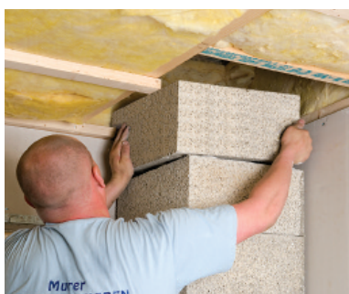
Element før bjelkelag monteres. Dersom skorsteinen føres gjennom flere boenheter, skal den påføres et pusslag på 10 mm i hele bjelkelagets tykkelse.
