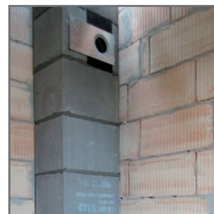
5.20 Beépített LAS csatlakozó.
