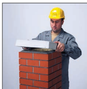
4.7 Az utolsó kéményfej elemre hordjunk fel habarcsot és tegyük fel a könnyű-beton fedkövet.
