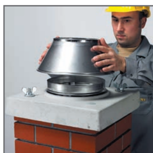
4.10 Az utolsó csövet szükség szerint kell méretre vágni, ehhez helyezzük fel a torkolati kúpot...
