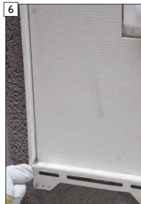
6 Az építéskor visszavágott védőtömítés az ajtózsanéroknál.
