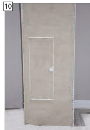
10 A kész alapvakolás képe. FONTOS! A gyártó által ajánlott száradási időt be kell tartani!
