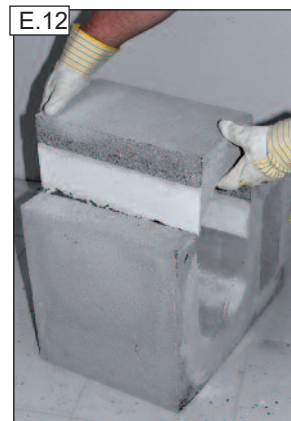
A köpenytégladarabot emeljük ki. A nyílásba került szigetelőanyag törmelékét távolítsuk el.
