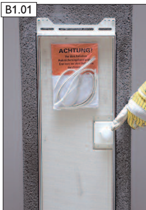
B1.01 A BlowerDoor rejtett kéményajtó zárját fedőkupakkal látták el.
