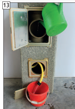
Kondensatteller und Siphonschlauch spülen.
