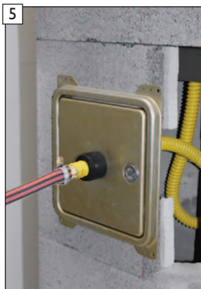
Beispiel: bauseitige Ableitung mittels Schlauch 3/4"
