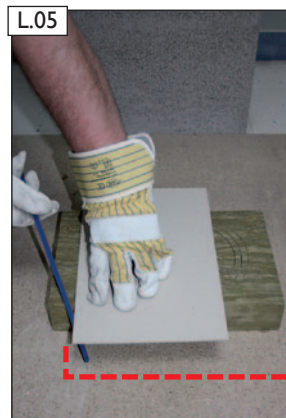
BDF mit der Dämmstoffsäge und der Schnittschablone (als Anschlagführung) zuschneiden. Den entstandenen BDF-Abschnitt an der Oberseite anlegen. Der innere Stützkern bleibt dabei als Aussteifung in der BDF.
