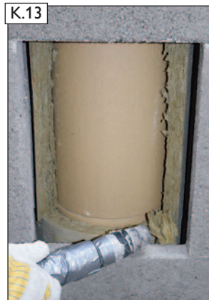
Zuluftkanäle von Dämmstoffresten freihalten.
