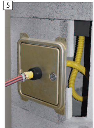
Beispiel: bauseitige Ableitung mittels Schlauch 3/4".
