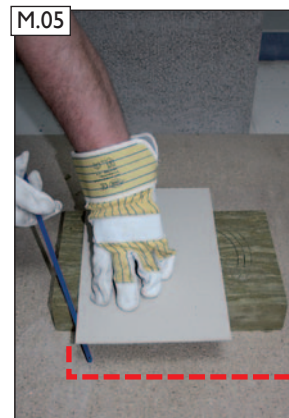
BDF mit der Dämmstoffsäge und der Schnittschablone (als Anschlagführung) zuschneiden. Den entstandenen BDF-Abschnitt an der Oberseite anlegen. Der innere Stützkern bleibt dabei als Aussteifung in der BDF.
