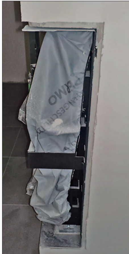
Ansicht nach erfolgtem umlaufenden bauseitigen Rückschnitt
