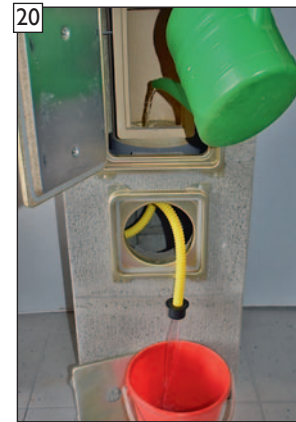
20 Kondensatteller und Siphonschlauch spülen.
