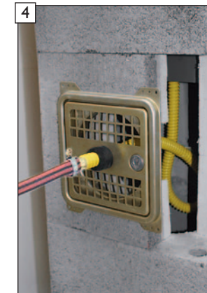
4 Beispiel: bauseitige Ableitung mittels Schlauch 3/4".
