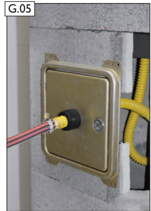
Beispiel: bauseitige Ableitung mittels Schlauch 3/4".
