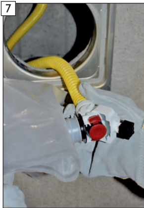
BIB-Anschlussrohr des Kondensatauffangbeutels in die Aufnahme des Kuppelungsteils vom BIB-Connector einstecken.
