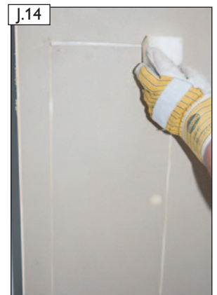
J.14 Schutzdichtung mit Schwamm nacharbeiten.
