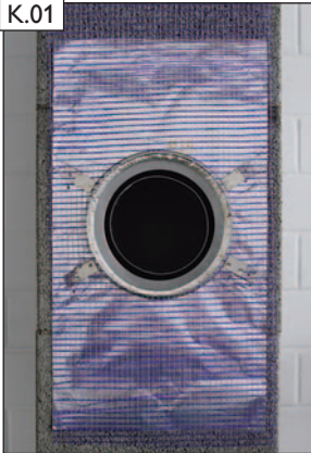
Ansicht Feuerstättenanschluss mit eingebautem Schiedel Edelstahl-Anschlussfutter.
