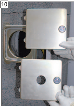
BlowerDoor Kondensatblendentürblatt wieder einsetzen.
