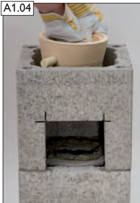
Öffnungsstein für Zuluftgittereinbau und Sockelstein in Mörtel MG(M5) IIa (Mauermörtel nach EN 998-2) versetzen.
