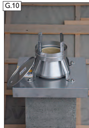
Der Revisionsdeckel ist mit einer Drahtschlinge, als „Absturzsicherung“, verbunden. Die Drahtschlauenfensicherung mind. einmal im Jahr überprüfen und ggf. erneuern.
