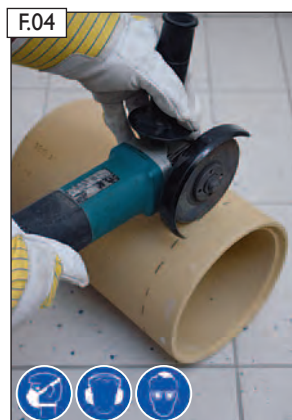
An der Nutseite des Schamotte Rohrs anzeichnen und mit Winkelschleifer zuschneiden. ACHTUNG! Beachten Sie bitte die Hinweise zum Arbeitsschutz auf Seite 2!
