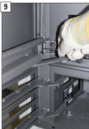
9 ... Zuluftblende müssen dazu nicht entfernt werden.
