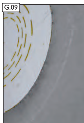
Podrobný pohled: Později osazená sádkartonová deska nesmí hliníkovou fólii poškodit!
