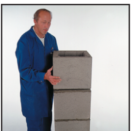
22 Следващите коминни тела, керамични тръби и вата се монтират по аналогичен начин до достигане на желаната височина.
